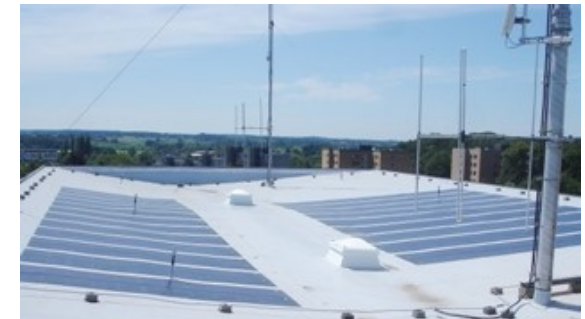
Foto: PV auf dem Dach von Gebäude B Kreis Stormarn
